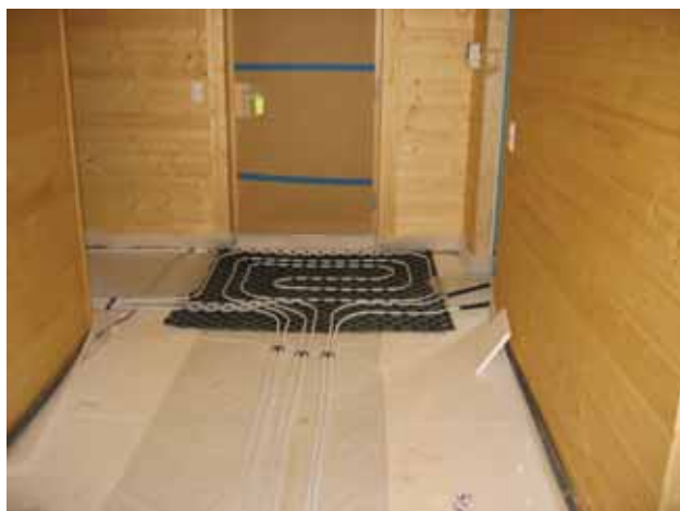
Razvod instalacija i površinsko grijanje u hodniku
