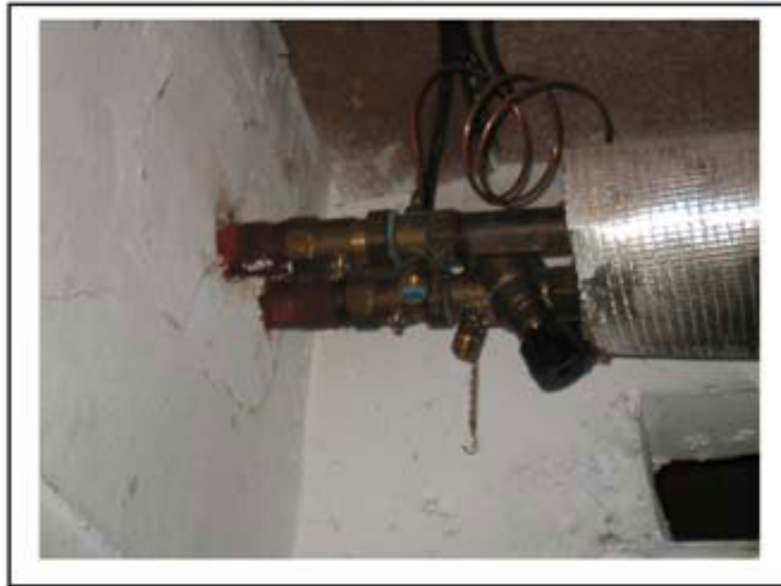
Slika 26. Ugrađeni HERZ regulator diferencijalnog tlaka i protoka
