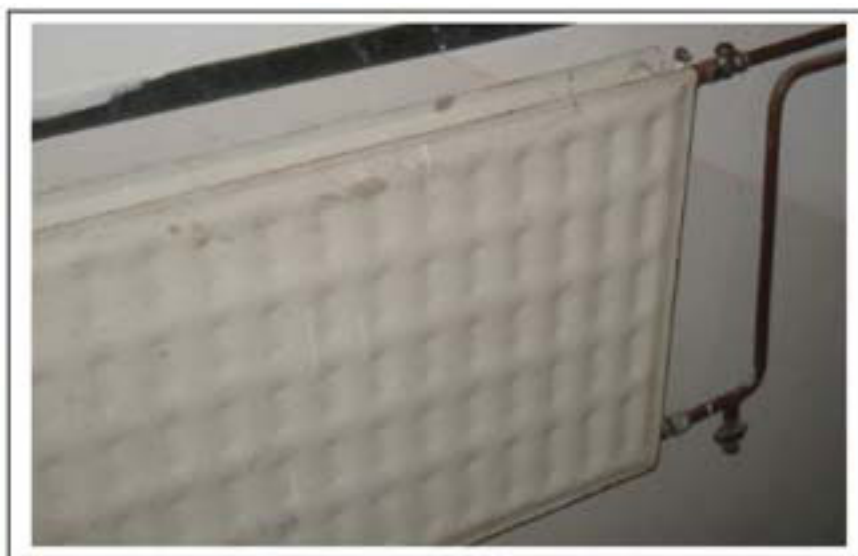
Slika 25. Grijaće tijelo na vertikali stubišta
