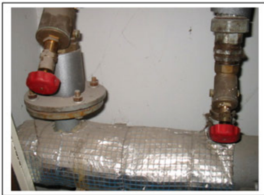
Slika 28. Ugrađeni HERZ regulacijski ventil ogranka
